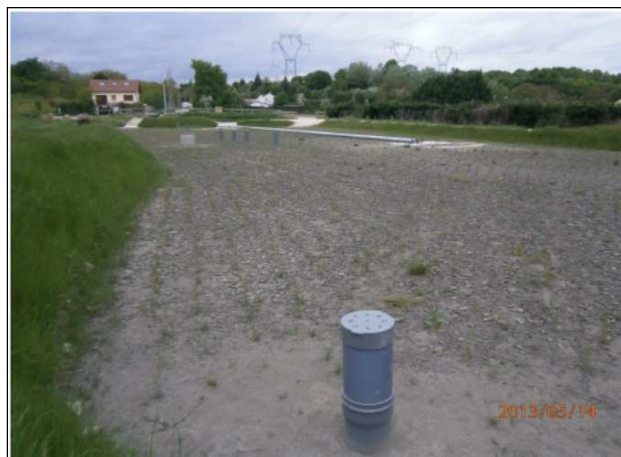
Figure 9 : Filtre planté de roseaux sur le site d'étude (Leuville et St Germain les Arpajon)
